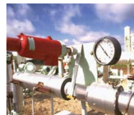
Rozvody plynu: vlhkost poškozuje rozvody a snižuje hodnotu plynu v síti
