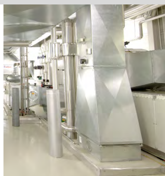
Kontrola klimatu v kanálech
